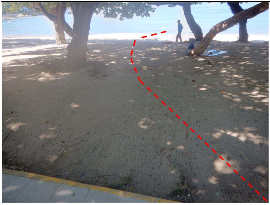
圖 2.3 光纜路線上為確保樹根所受滋擾最少的主要手掘纜槽地區（向海方向）
