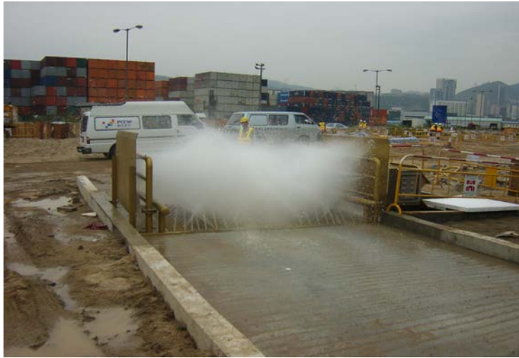
自動車輪清洗設備
