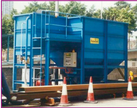
设于建筑地盘的 污水处理系统
