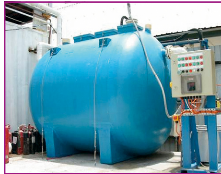
设于建筑地盘的 洗手间污水处理系统
