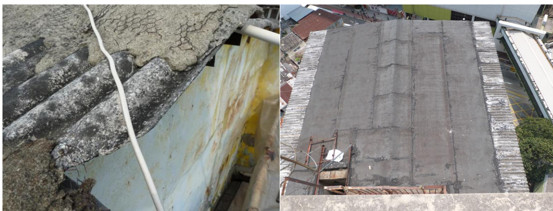
被水泥砂漿覆蓋的石棉瓦屋頂擋板
