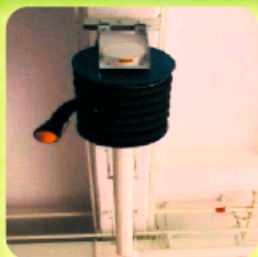
車輛廢氣收集設施
