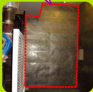
隔音物料 (牆壁、天花及門)
