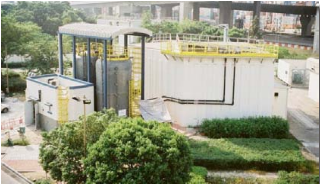
昂船洲污水處理廠的前期消毒設施
