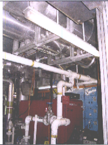
在鍋爐室內的煙道
