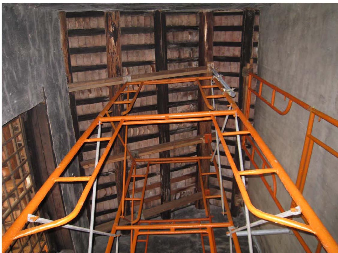
相片二 宗祠內的木桁已嚴重破損。
