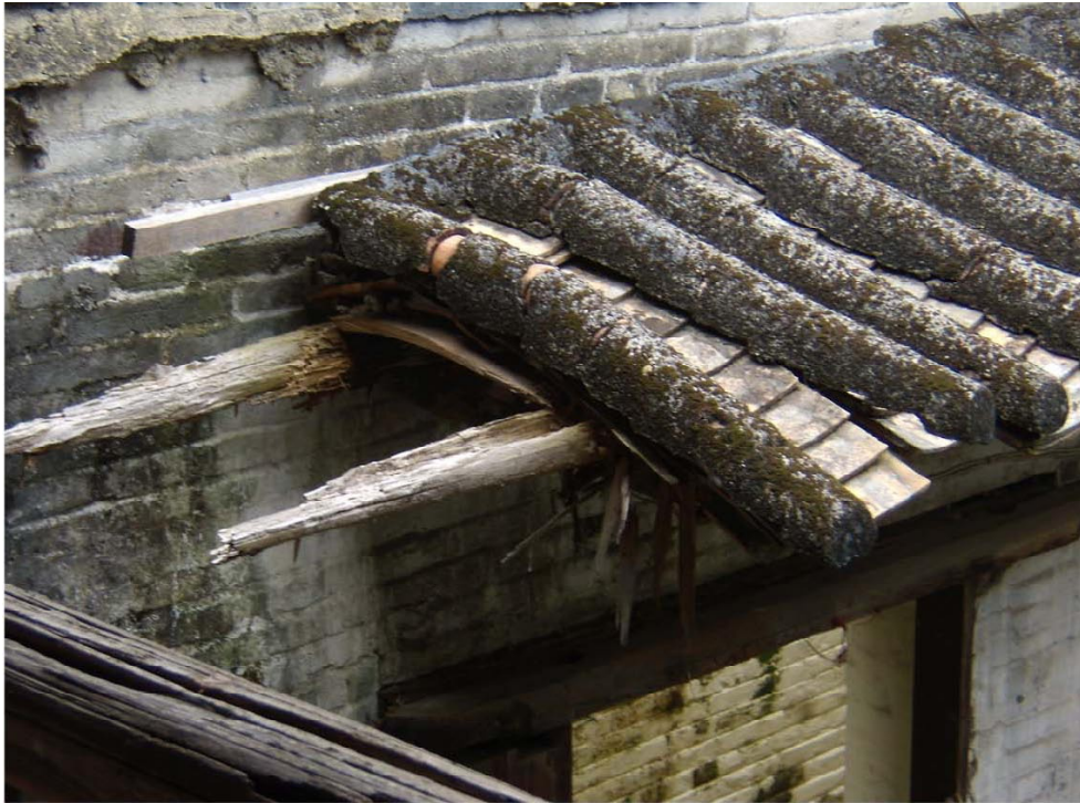
相片七 禮賓樓破損/鬆脫的瓦頂及桁桷
