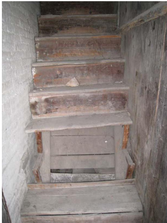
相片八 禮賓樓的木樓梯及閣樓木地板已破爛
