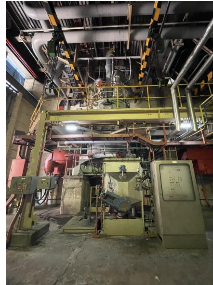
Photo 17: A coal grinding mill unit 照片 17 : 碾煤機
