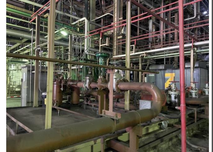
Photo 15: Fuel oil heaters 照片 15 : 燃油加熱器
