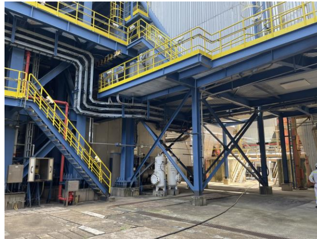
Photo 65: Structures of the Flue Gas Desulphurisation (FGD) plant 照片 65：煙氣脫硫裝置的結構
