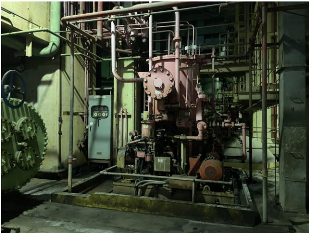
Photo 34: Seal oil supply unit at L3 照片 34 : L3號機組的密封油輸送機
