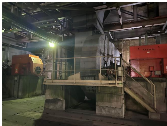
Photo 40: Primary air fan units 照片 40：主送風機
