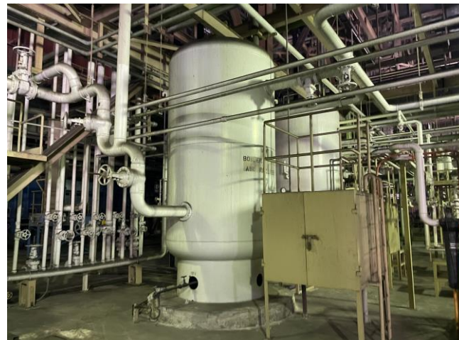
Photo 41: Boiler air receiver units 照片 41：鍋爐機空氣容器機
