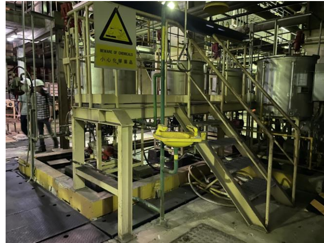
Photo 20: Chemical dosing system at L2 照片 20 : L2號機組的化學劑投配系統
