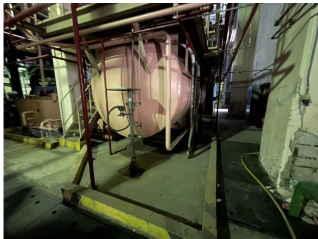
Photo 26: Main oil tank at L2 照片 26 : L2號機組的主油缸
