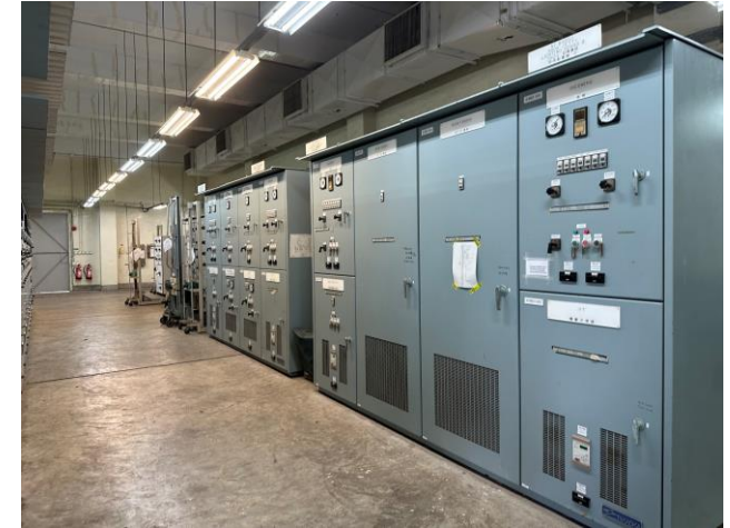
Photo 87: Switchgear room in the GT57 & Coal Jetty Electrical Equipment Building 照片 87 : GT57號機組及運煤碼頭電氣設備機樓內的開關設備室
