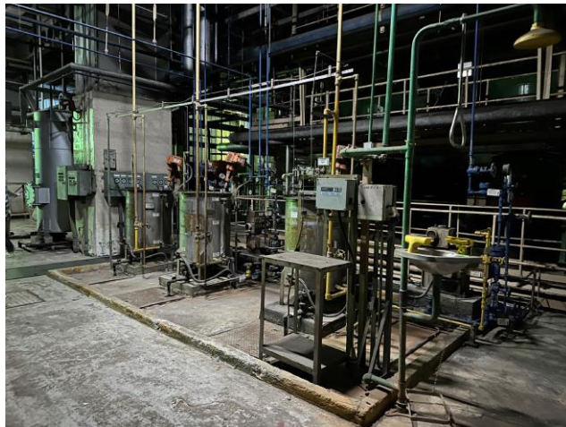
Photo 22: Chemical dosing system at L3 照片 22 : L3號機組的化學劑投配系統
