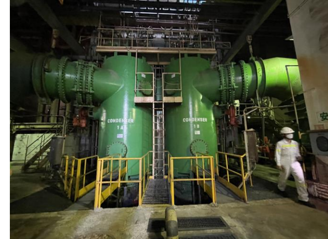
Photo 36: Condenser unit 照片 36 : 冷凝機組
