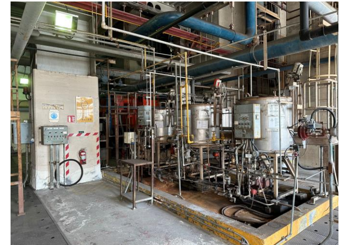
Photo 18: Chemical dosing system at L1 照片 18 : L1號機組的化學劑投配系統
