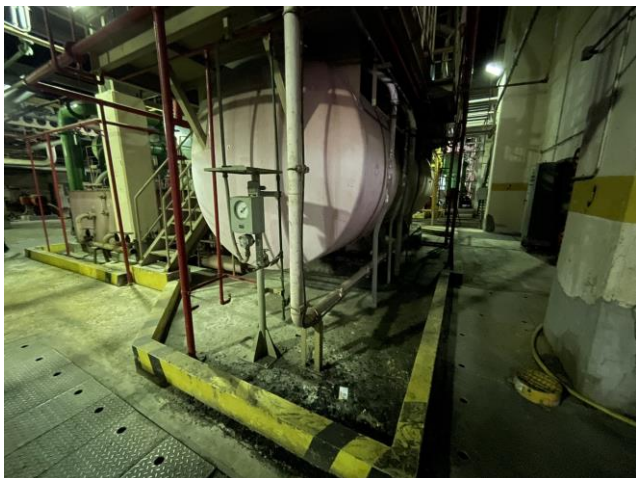
Photo 25: Main oil tank at L1 照片 25 : L1號機組的主油缸
