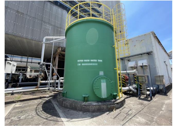
Photo 69: Water tank for the FGD plant 照片 69：煙氣脫硫裝置的水缸
