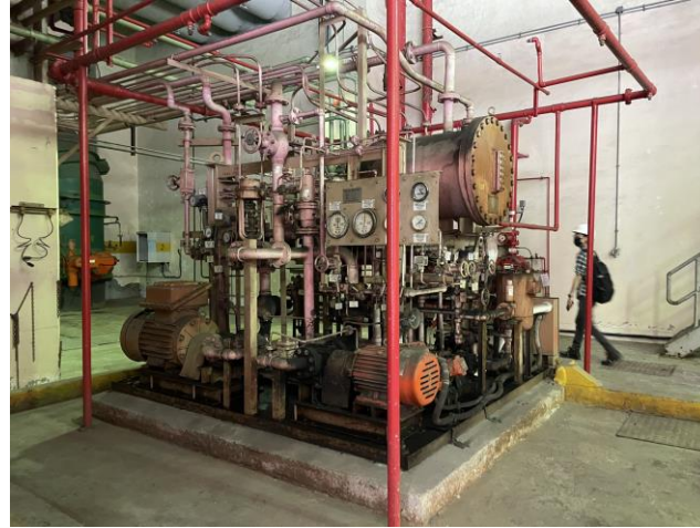
Photo 32: Seal oil supply unit at L1 照片 32 : L1號機組的密封油輸送機
