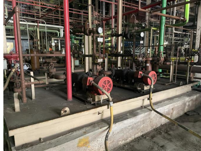
Photo 14: Fuel oil pumps 照片 14 : 燃油泵
