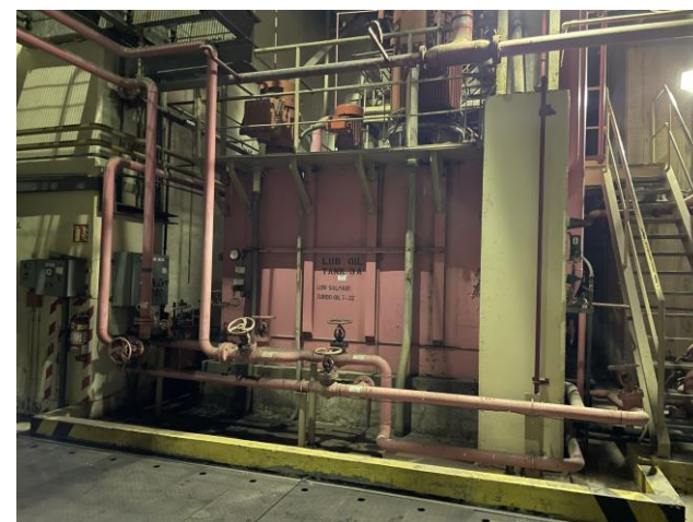
Photo 27: Lubrication oil tank at L3 照片 27 : L3號機組的潤滑油缸
