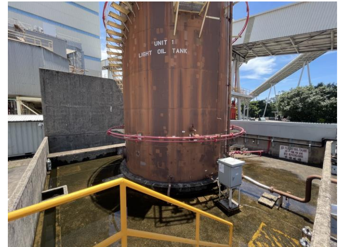
Photo 72: Unit 1 Light Oil Tank 照片 72：一號輕質油儲存缸
