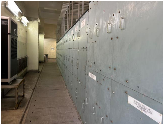
Photo 88: Switchgear room in the GT57 & Coal Jetty Electrical Equipment Building 照片 88 : GT57號機組及運煤碼頭電氣設備機樓內的開關設備室
