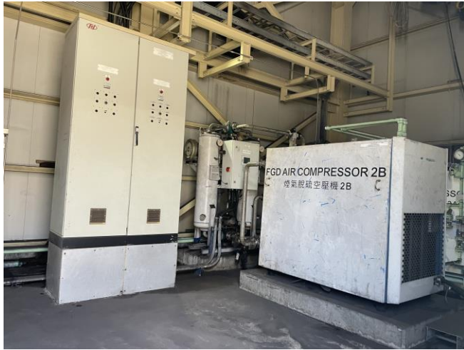
Photo 67: The air compressor units of the Flue Gas De-sulphurisation (FGD) plant 照片 67：煙氣脫硫裝置的空氣壓縮機
