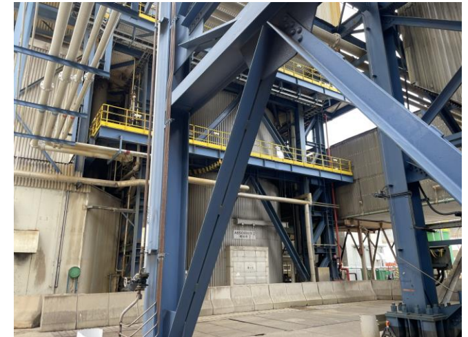
Photo 66: The absorber of the Flue Gas Desulphurisation (FGD) plant 照片 66：煙氣脫硫裝置的吸收器
