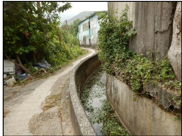
周邊發展直接排放污水至渠道
