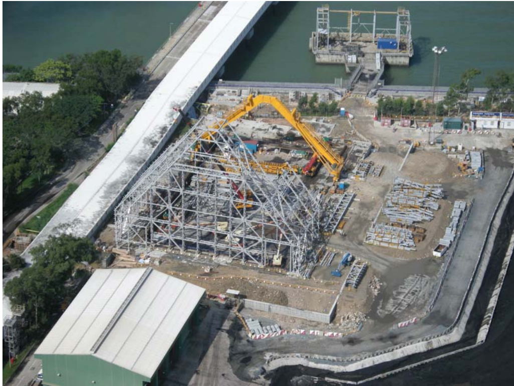
E. 3 Gypsum Handling Area
