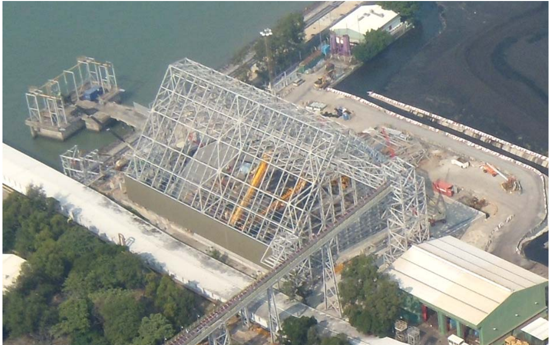
E. 3 Gypsum Handling Area
