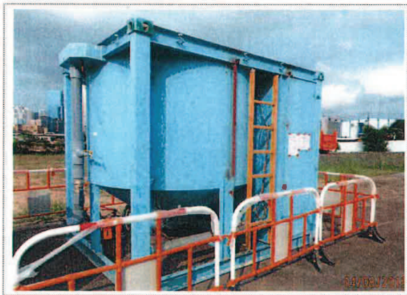
Wastewater treatment plant 污水處理器
