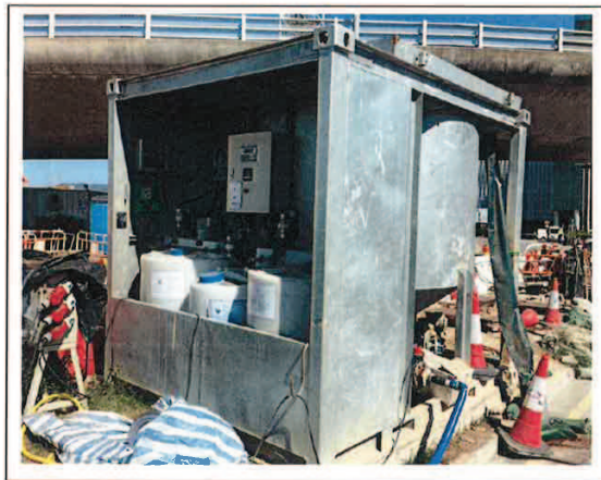
Wastewater treatment plant 污水處理器
