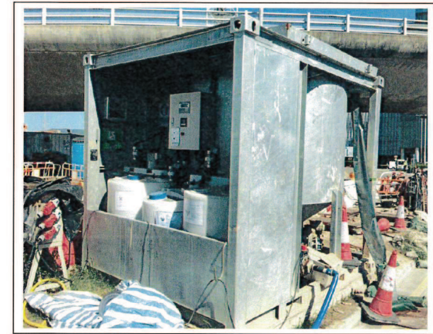
Wastewater treatment plant 污水處理器
