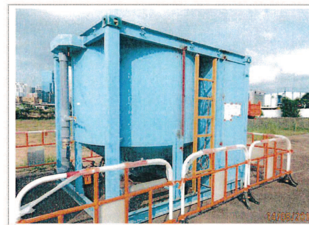
Wastewater treatment plant 污水處理器
