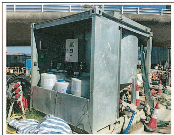
Wastewater treatment plant 污水處理器
