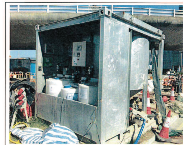
Wastewater treatment plant 污水處理器
