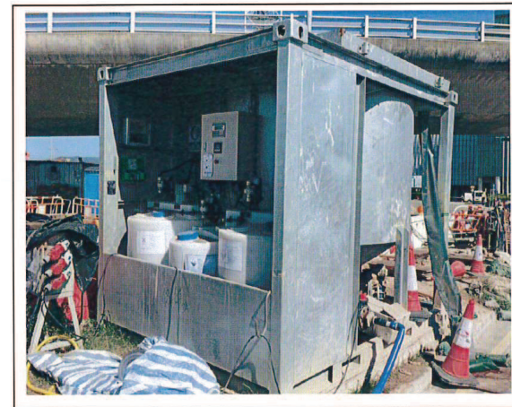
Wastewater treatment plant 污水處理器
