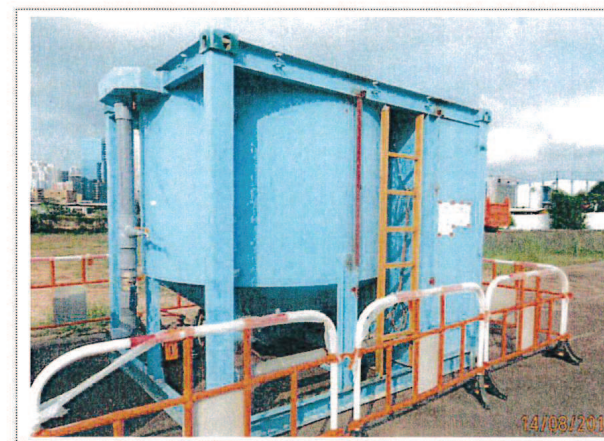
Wastewater treatment plant 污水處理器
