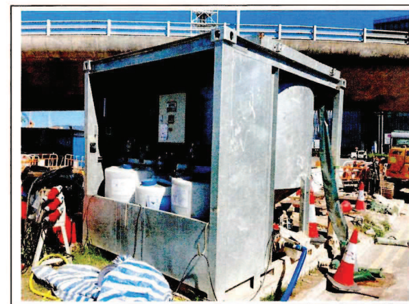
Wastewater treatment plant 污水處理器
