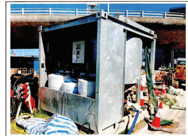
Wastewater treatment plant 污水處理器
