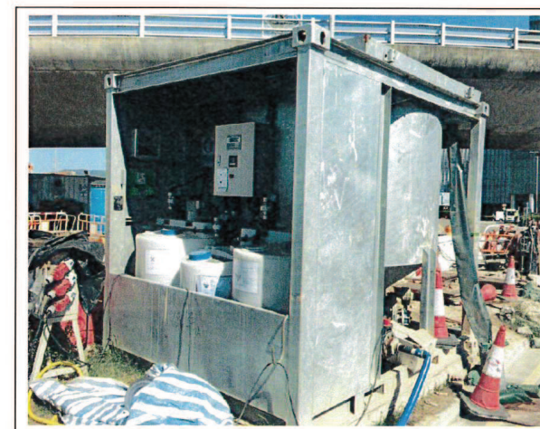
Wastewater treatment plant 污水處理器
