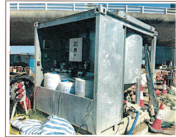
Wastewater treatment plant 污水處理器
