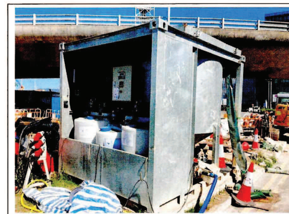
Wastewater treatment plant 污水處理器
