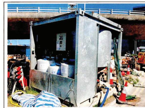
Wastewater treatment plant 污水處理器
