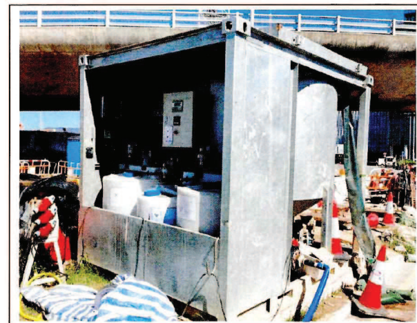
Wastewater treatment plant 污水處理器
