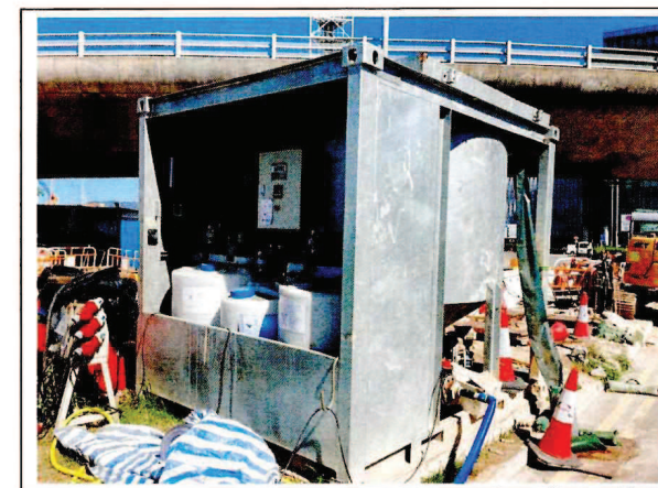
Wastewater treatment plant 污水處理器
