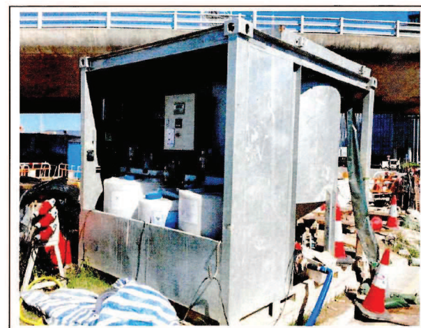
Wastewater treatment plant 污水處理器
