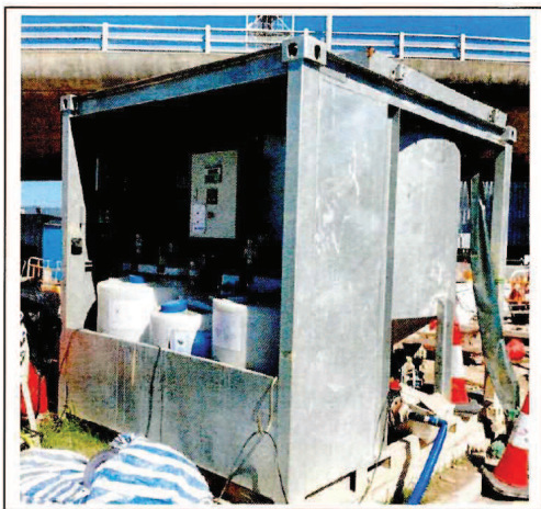
Wastewater treatment plant 污水處理器
