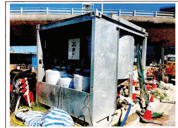
Wastewater treatment plant 污水處理器
