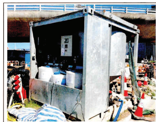
Wastewater treatment plant 污水處理器
