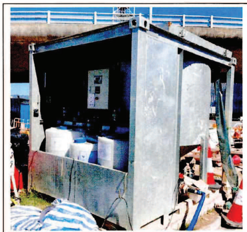
Wastewater treatment plant 污水處理器
