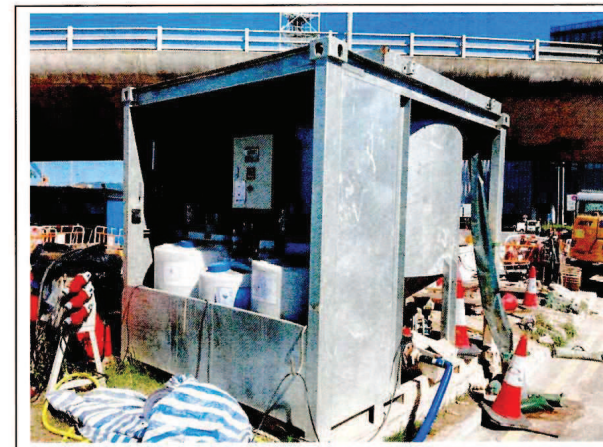
Wastewater treatment plant 污水處理器
