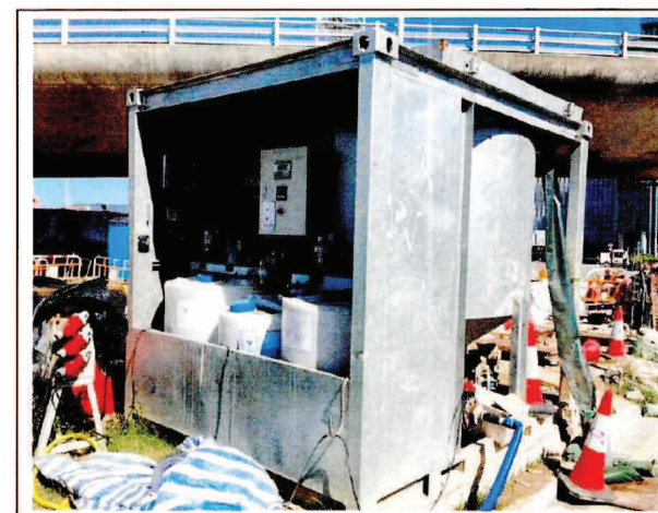
Wastewater treatment plant 污水處理器
