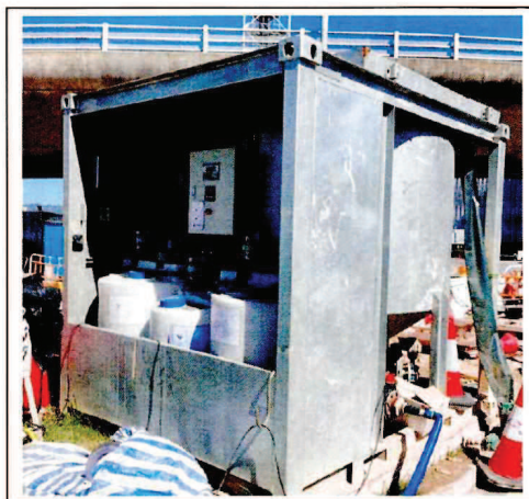
Wastewater treatment plant 污水處理器
