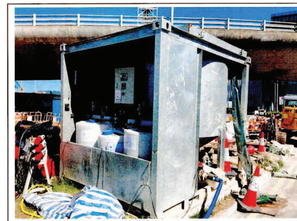
Wastewater treatment plant 污水處理器
