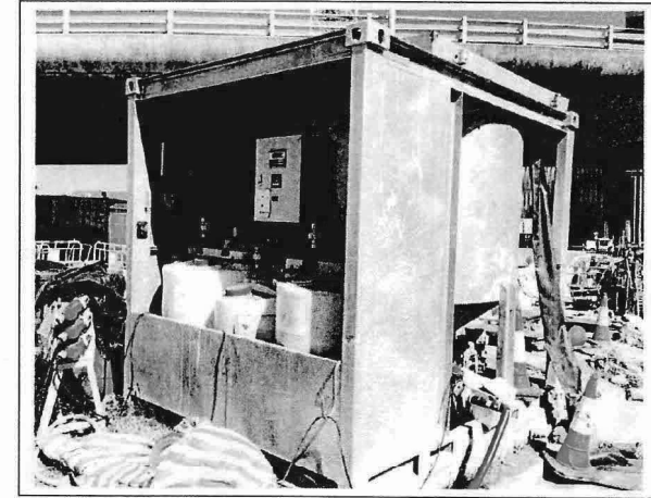
Wastewater treatment plant 污水處理器
