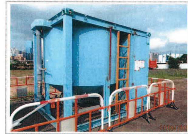
Wastewater treatment plant 污水處理器
