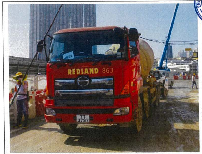
Concrete lorry mixer (Vehicle No. TT3797) 混凝土攪拌車 (車牌號碼 TT3797)
