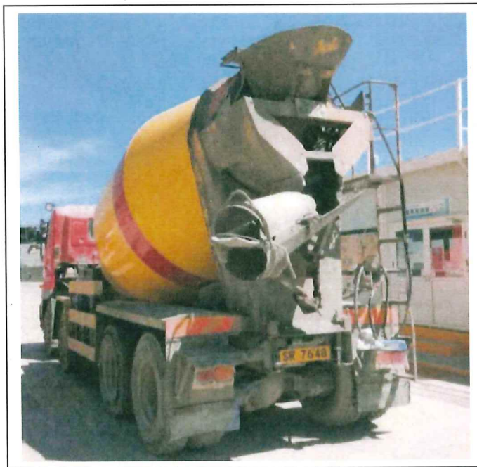
Concrete lorry mixer (Vehicle No. SR7648) 混凝土攪拌車 (車牌號碼 SR7648)
