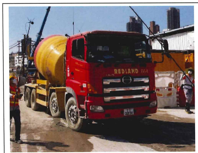
Concrete lorry mixer (Vehicle No. TT3231) 混凝土攪拌車 (車牌號碼 TT3231)
