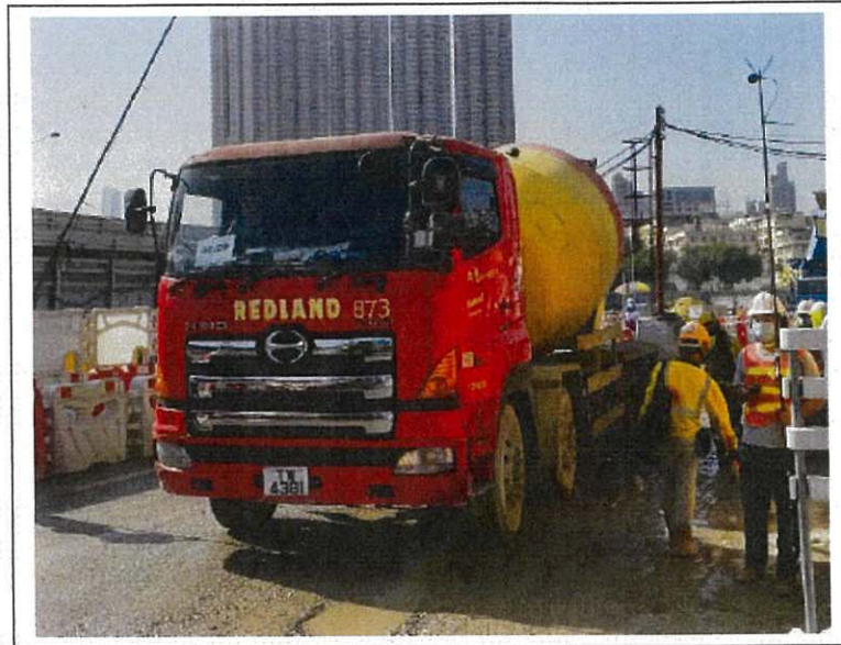
Concrete lorry mixer (Vehicle No. TW4381) 混凝土攪拌車 (車牌號碼 TW4381)
