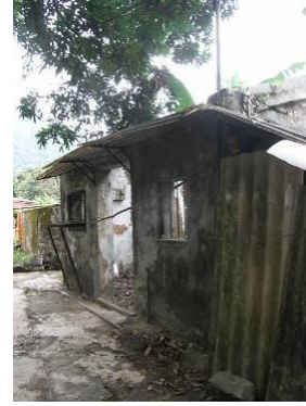
TP02 - Ruin in Tai Po Kau Lo Wai 大埔滘老圍廢屋
