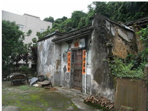
TP09 - Ruin in Tai Po Kau San Wai 大埔滘新圍廢屋
