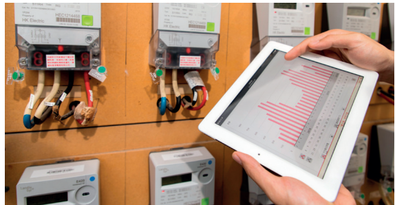
智能電錶可更有效監察及管理用電情況
