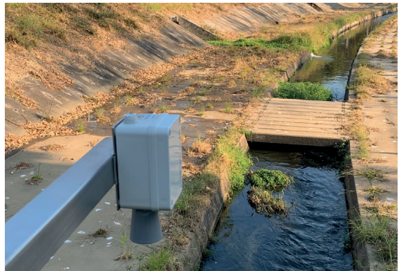
水位傳感器可實時監測河流和水道水位
