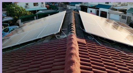
在上網電價計劃推出後，不少住宅的天台都安裝了太陽能發電系統
