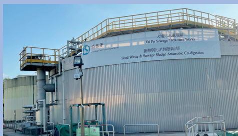
大埔污水處理廠的廚餘與污泥共消化設施
