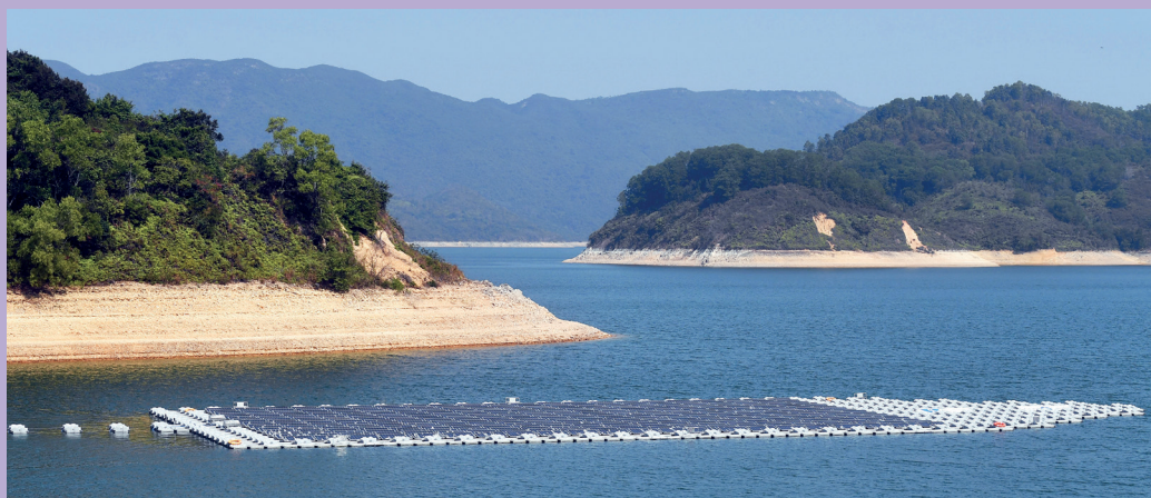
位於船灣淡水湖的浮動太陽能發電系統。水塘的清涼及開揚環境令太陽能發電系統的產電效能較一般屋頂或地面裝置高約20%
