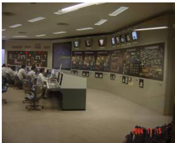
圖 6 新江東焚化爐的中央控制室
