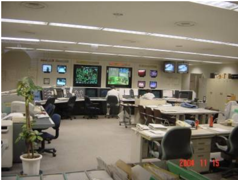
圖 3 有明海焚化爐的中央控制室
