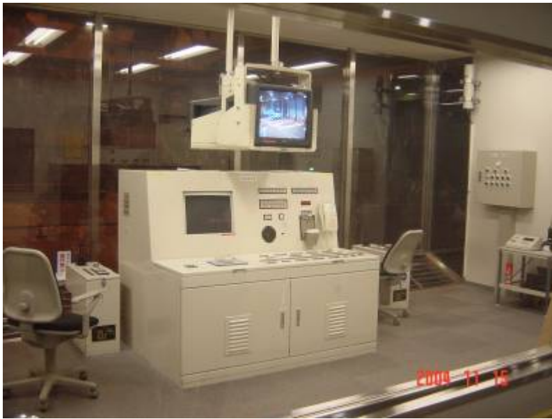
圖 2 把廢物由廢物艙抓運到燃燒斗的操作室
