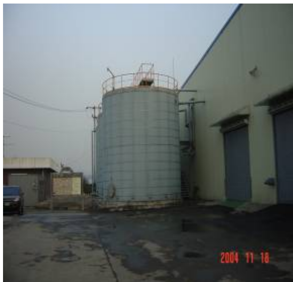
圖 24 坡州市厭氧分解設施的一部分，照片中所見為淤泥密封倉及廢物脫水工場
