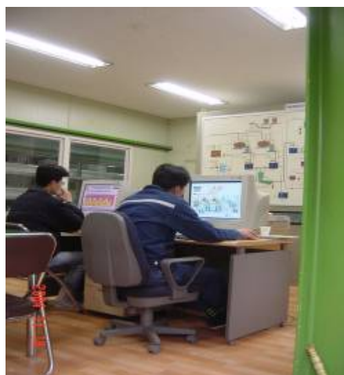
圖 25 坡州市厭氧分解設施的控制室
