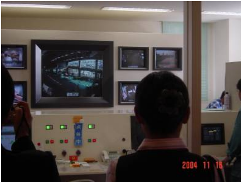
圖 15 旭川淨化中心公眾設施的控制室
