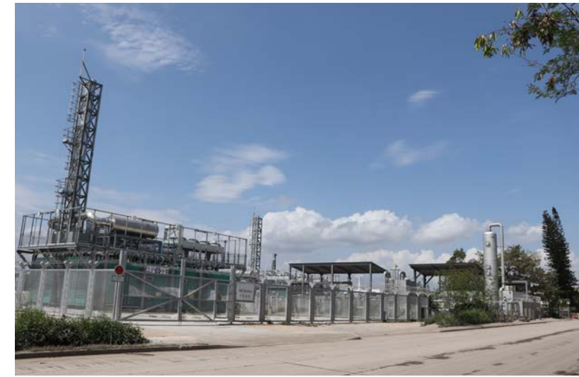
新界西堆填區的堆填氣體發電設施
