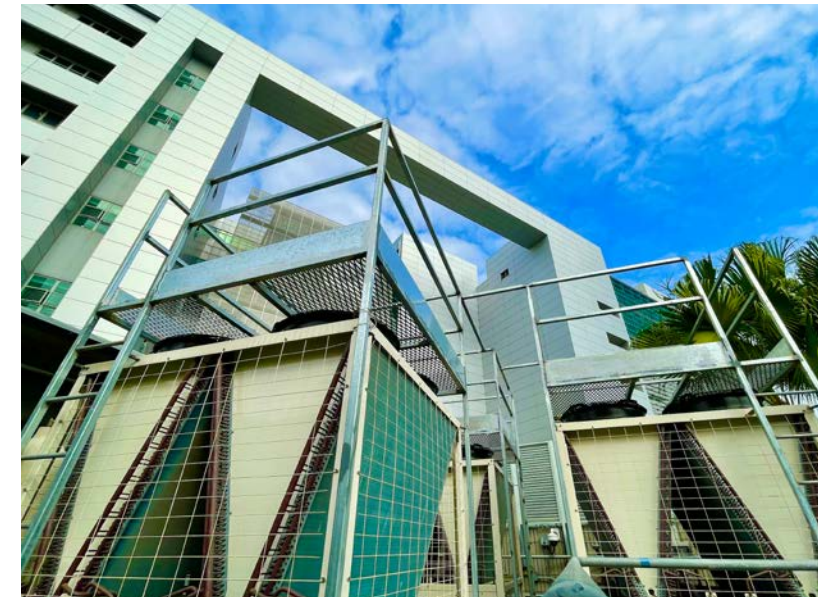
《建築物能源效益條例》涵蓋中央空調系統
