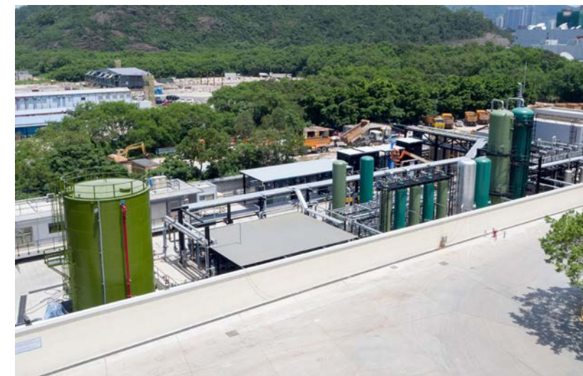
新界東南堆填區的堆填氣體回收設施
