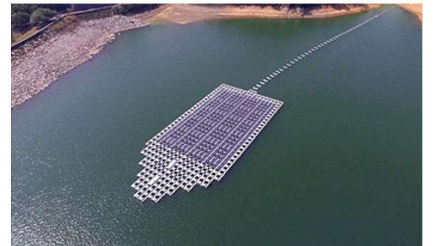
| 净零发电-船湾淡水湖的浮动太阳能发电系统
