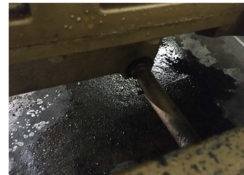
土地受污染的迹象—源自柴油储存和后备发电设施的泄漏
