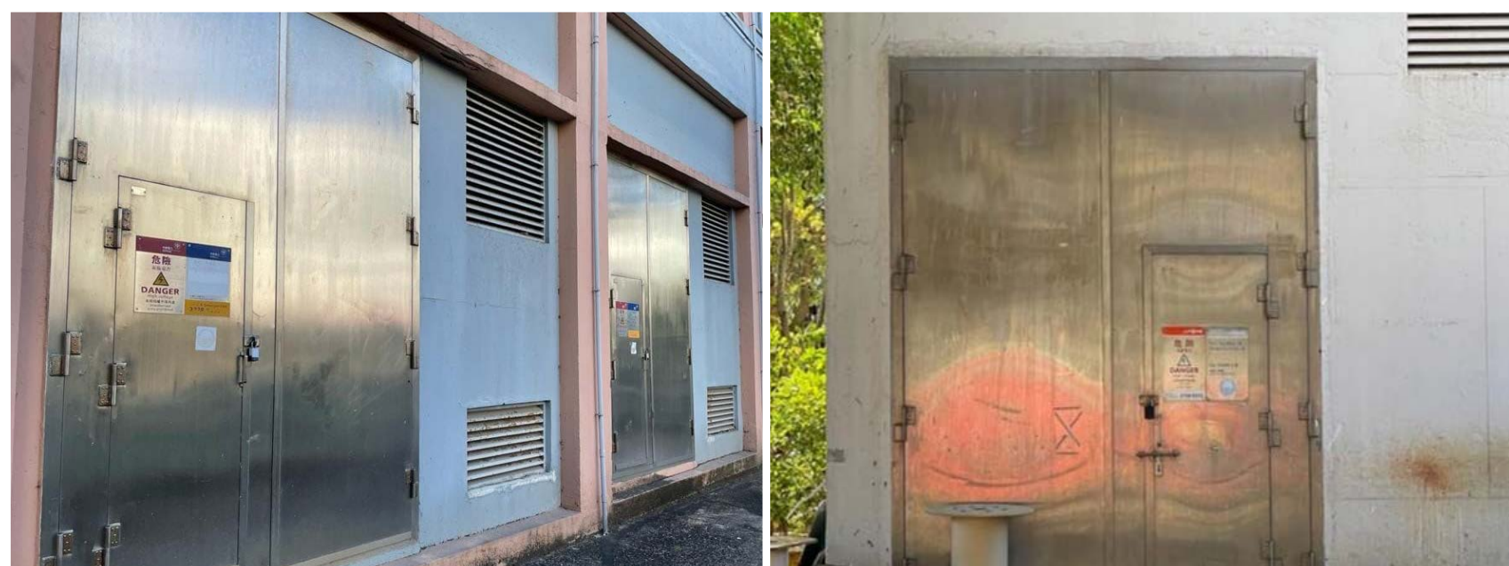
潜在土地污染热点—设置变压器的地方
