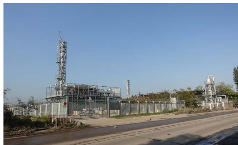
新界西堆填区的堆填气体发电设施
