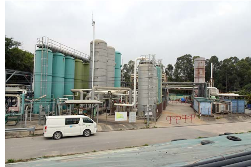
新界东北堆填区堆填气体处理设施
