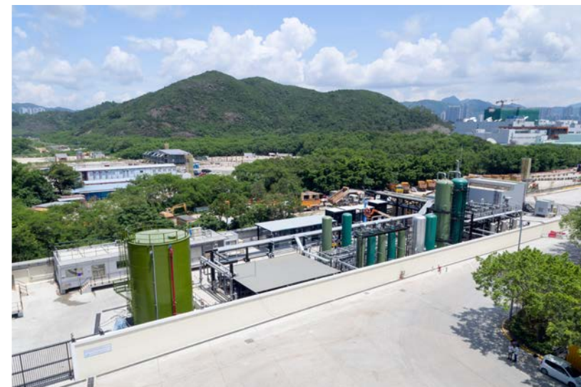
新界东南堆填区堆填气体回收设施
