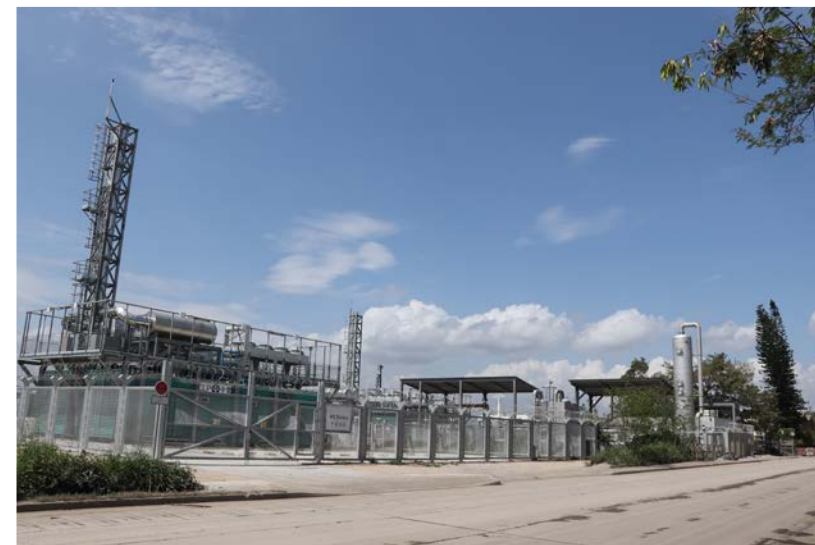
新界西堆填区的堆填气体发电项目
