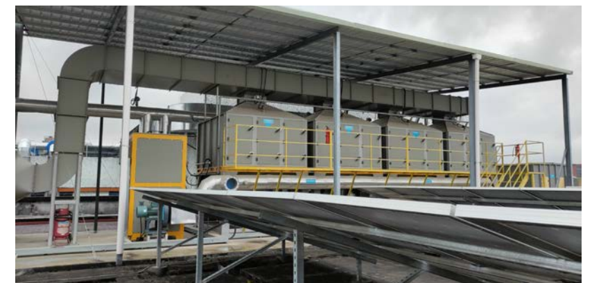
活性碳吸附濃縮器及催化燃燒技術組合以減少印刷工序所排放的揮發性有機化合物
