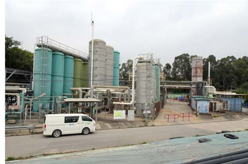
新界東北堆填區堆填氣體處理設施
