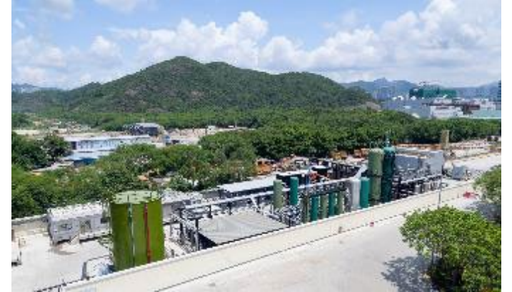
新界东南堆填区的堆填气体处理设施
