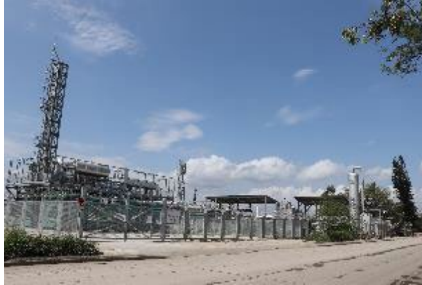
新界西堆填区的堆填气体发电项目
