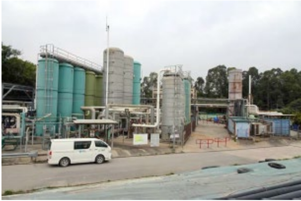
新界东北堆填区的堆填气体处理设施
