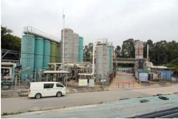
新界東北堆填區的堆填氣體處理設施
