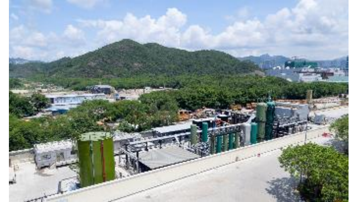
新界東南堆填區的堆填氣體處理設施
