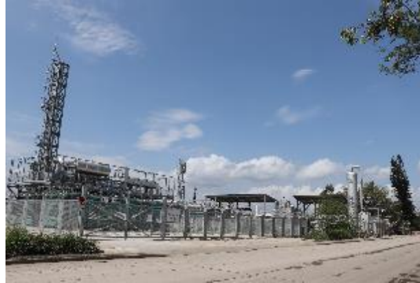
新界西堆填區的堆填氣體發電項目
