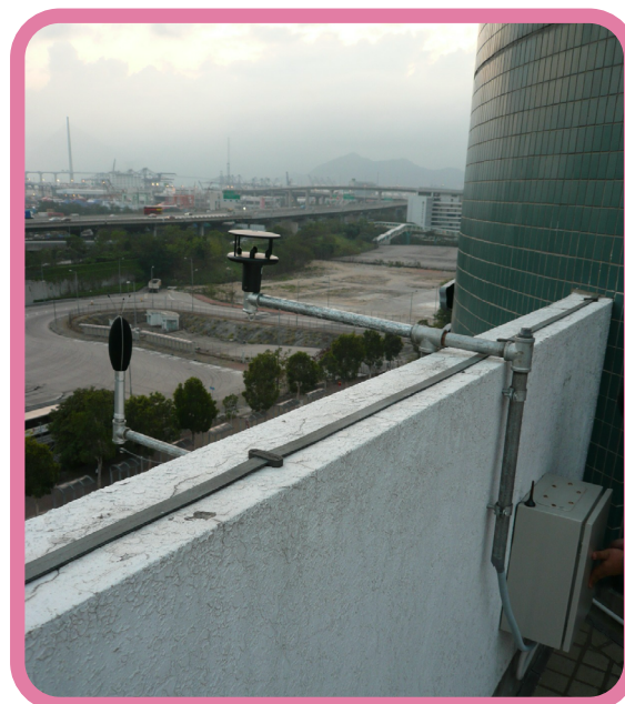
将概念付诸实行—在高铁香港段持续监测建筑噪音。 (相片由香港铁路有限公司提供)
