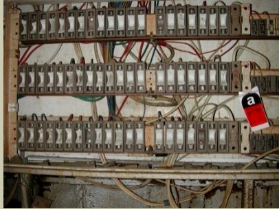
電掣箱絕緣墊片
