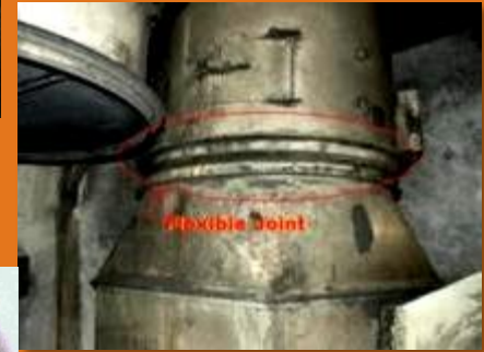
空調系統管道避震接口
