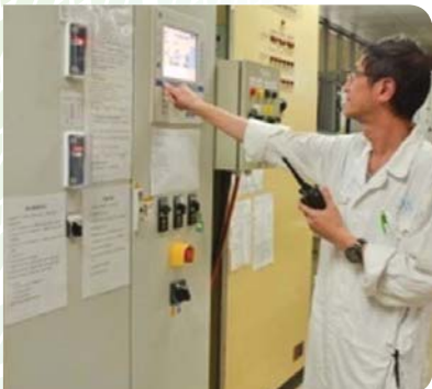
沙田污水處理廠的電熱聯供發電機控制板 Control panel for CHP generator at Shatin STW
