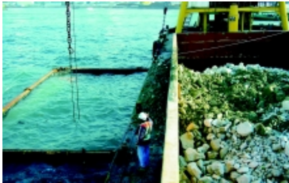
在隔泥幕內進行填海工程(填料來自其他政府工程挖出的剩餘物料) Filling within Silt Curtain (using surplus excavated material from other government projects)
