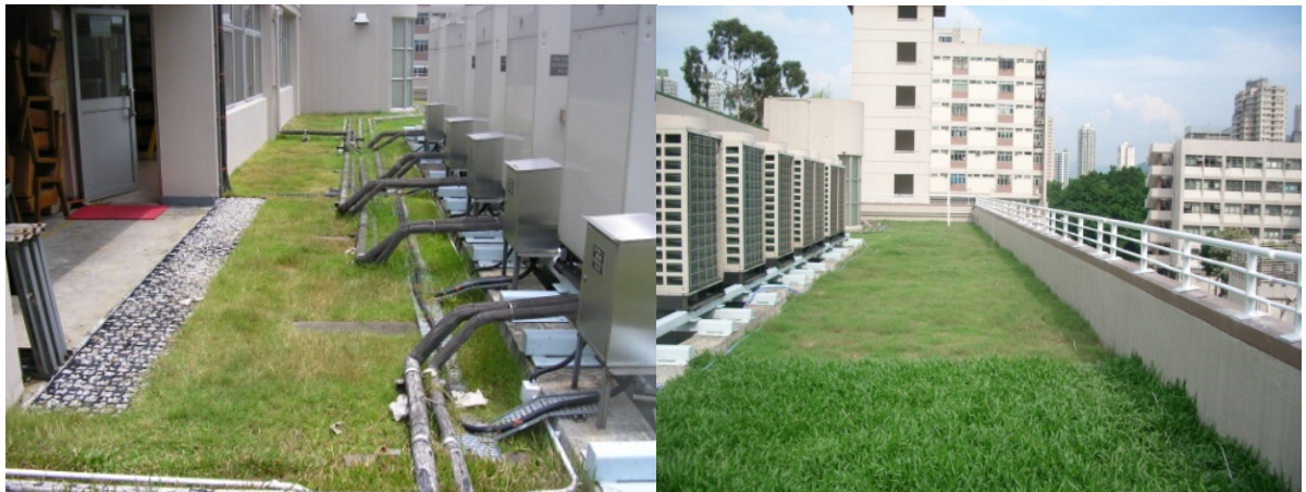
大埔救護站(圖左)、薄扶林救護站(圖右)屋頂的綠化天台
