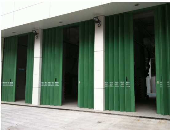
設有減低噪音裝置自動摺門的救護站
