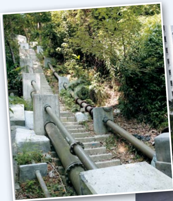
位於馬己仙峽的新鹹水水管 New salt water mains at Magazine Gap
