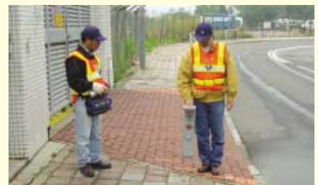
利用最先進的地下水管探測儀找尋水管的準確位置，為供水網絡進行主動監測。
