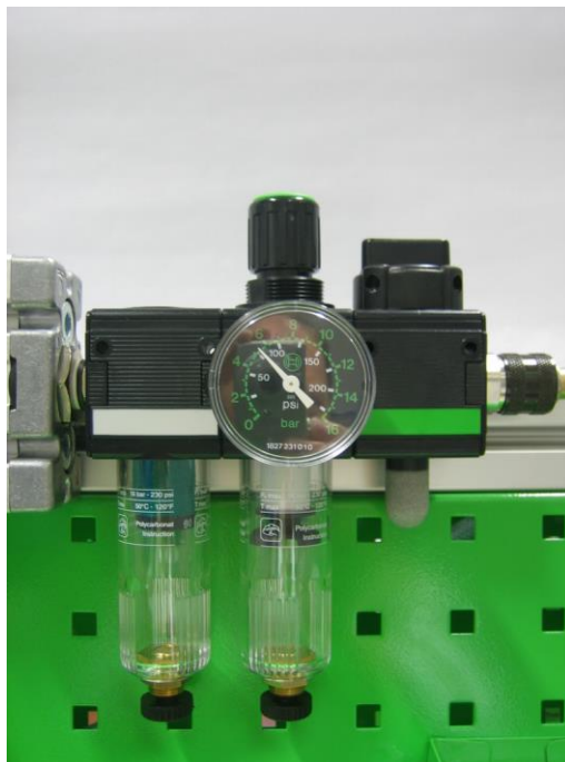
过滤压缩空气
