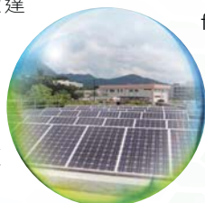
元朗污水處理廠的太陽能光伏板 PV panels at Yuen Long STW
