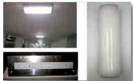
启德第一甲区试验安装LED凸面照明器
