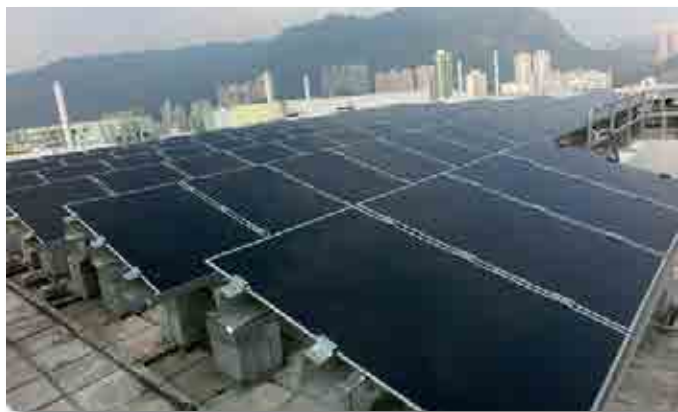
启德第一乙区的太阳能光伏板
