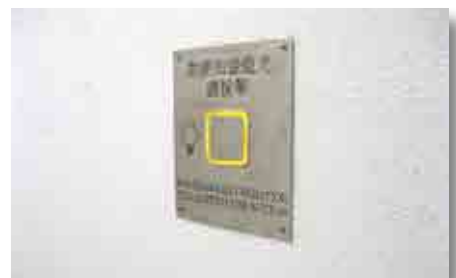
两级光度照明控制系统的手动开关按钮
