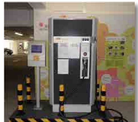
渔湾邨停车场的电动车充电设施
