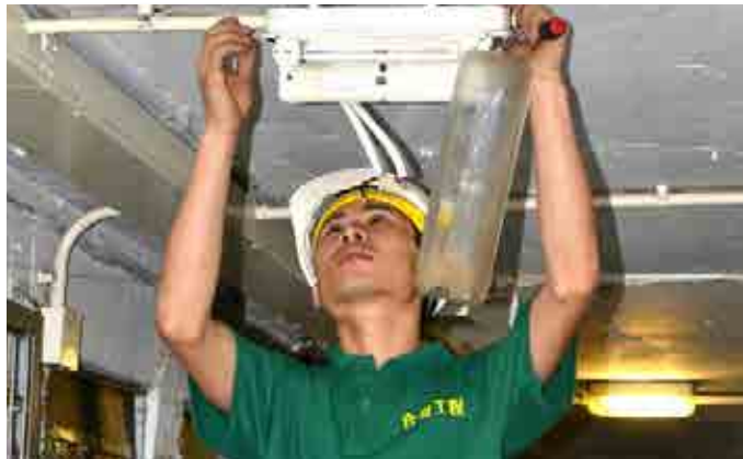
爱民邨安装使用电子镇流器的凸面照明装置
