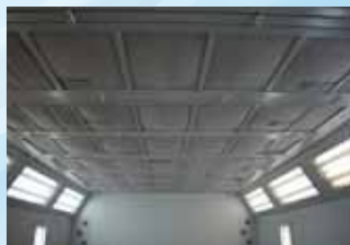
烤漆房內的抽風設備
